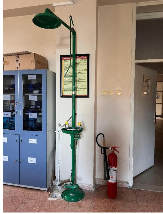
Fen-2 Laboratuvarı-Acil Vucüt Duşu ve Göz Duşu Ünitesi
